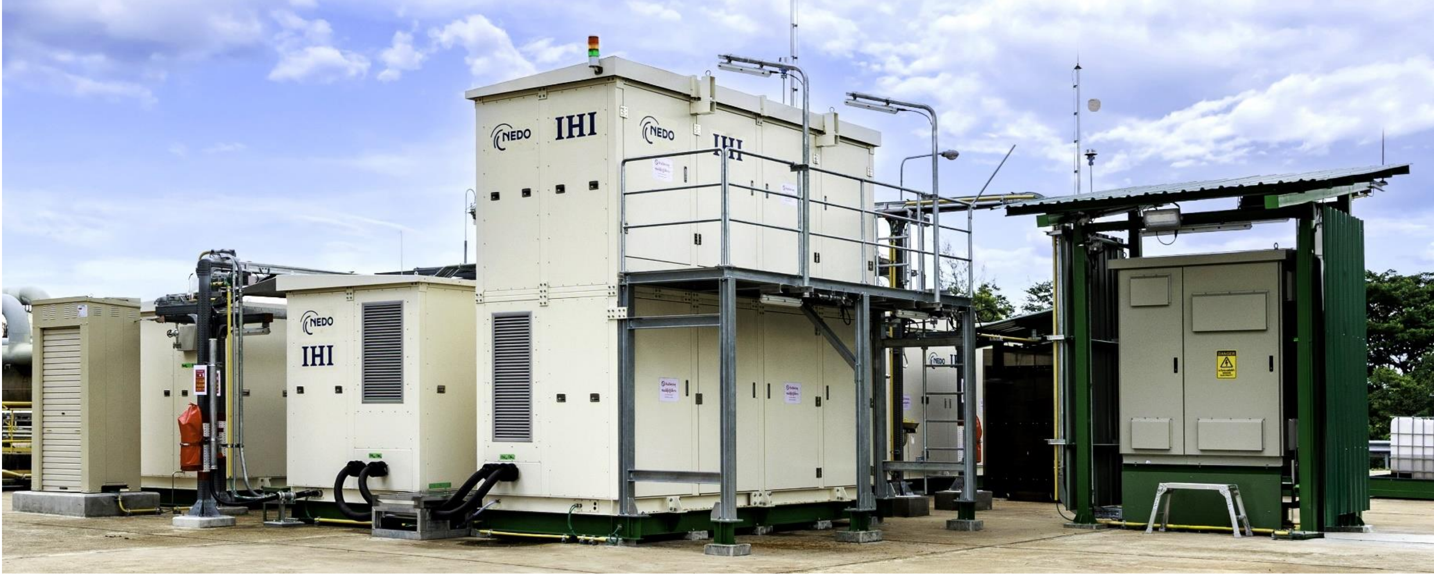
タイのナフサクラッカー商用プラントに設置のパイロット試験装置
