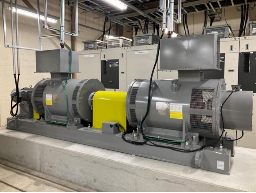
M-Gセット実証設備 M-Gセット、再エネ模擬装置、蓄電池模擬装置（いずれも100kVA）により構成
