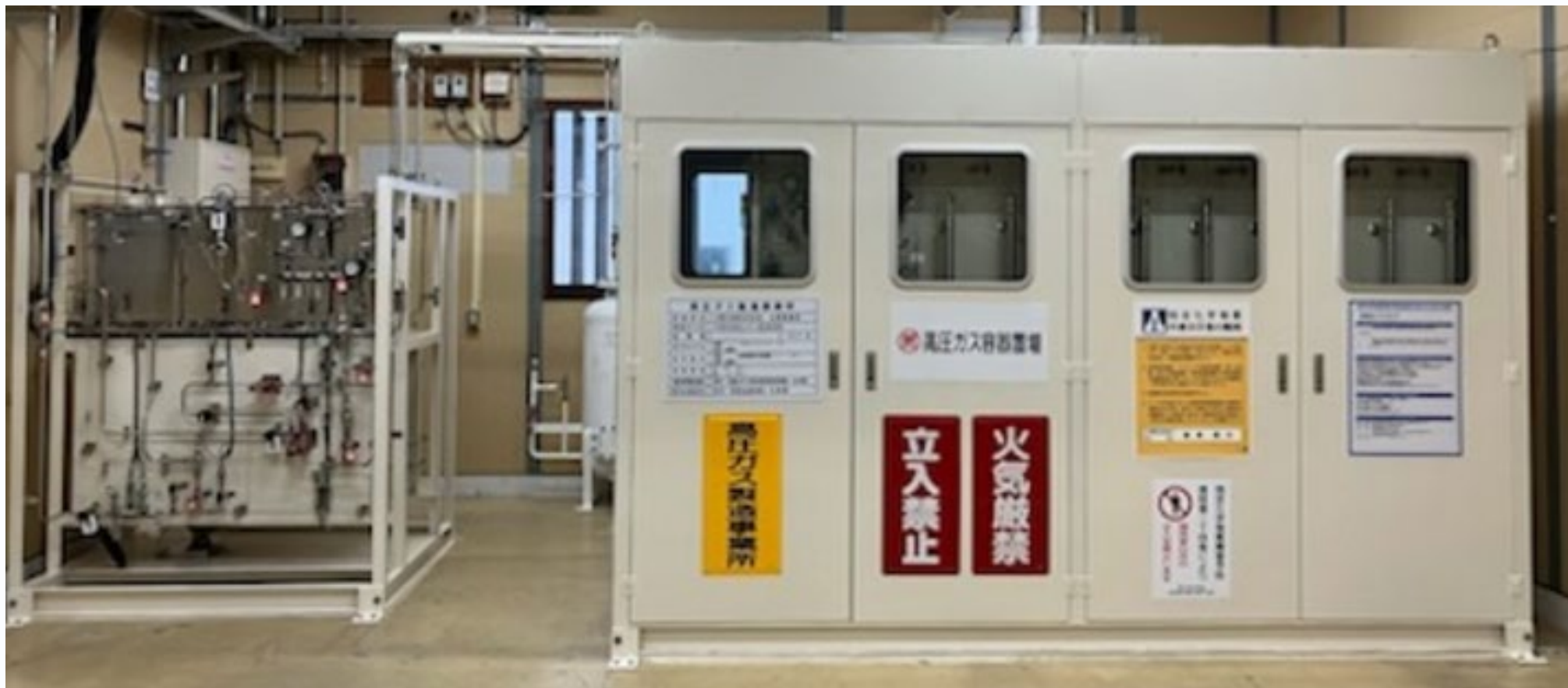
高圧ラバスケールPSA試験装置
