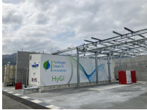
【マルチ圧力出荷設備】
