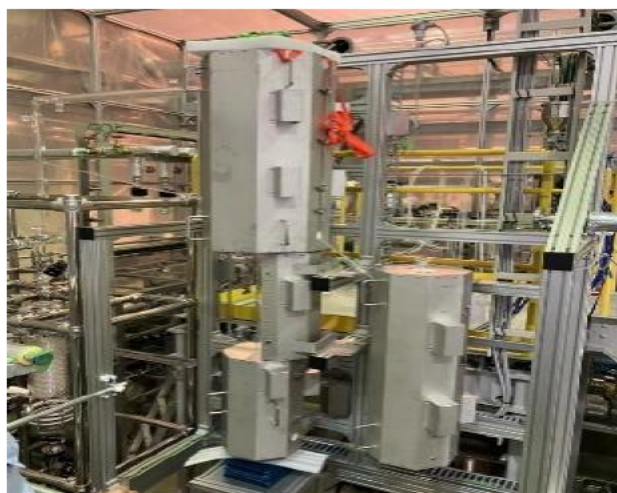
還元剤再生(水素製造)装置
