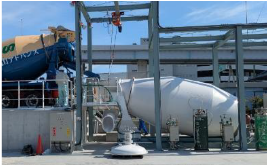
炭酸化粒状骨材(CP骨材)製造設備
