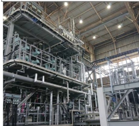
合成粗油製造 (FT合成反応設備)
