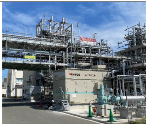
合成ガス製造 (逆シフト反応設備)
