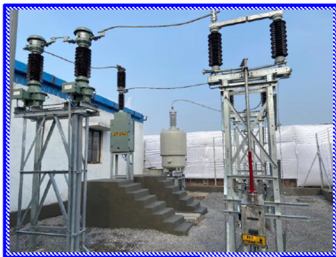
現地へ導入した 実証試験用マイクロ変電所
