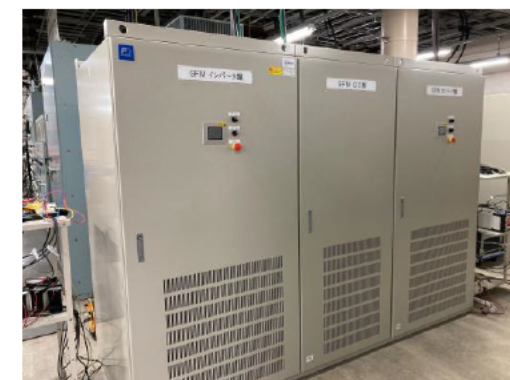
GFMインバータ実証設備
