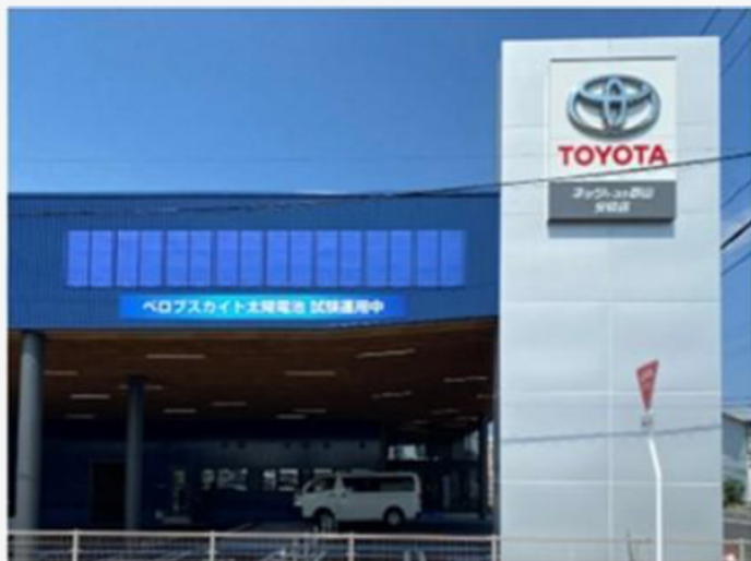
「ネッツトヨタ郡山 安積店」の店舗壁面に設置されたペロブスカイト太陽電池
