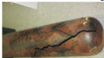
油圧衝撃で破裂した配管 (12インチ)
