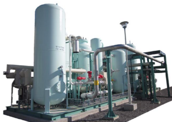
PSAガス分離装置
