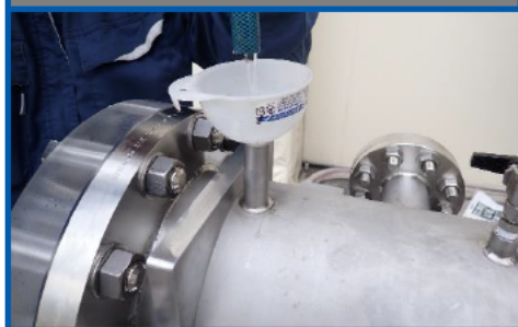
液体アンモニア充填口
