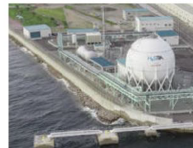
国内最大のLH 2 貯槽 2,500m 3 の球形貯槽
