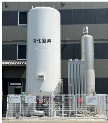
液化窒素試験設備
