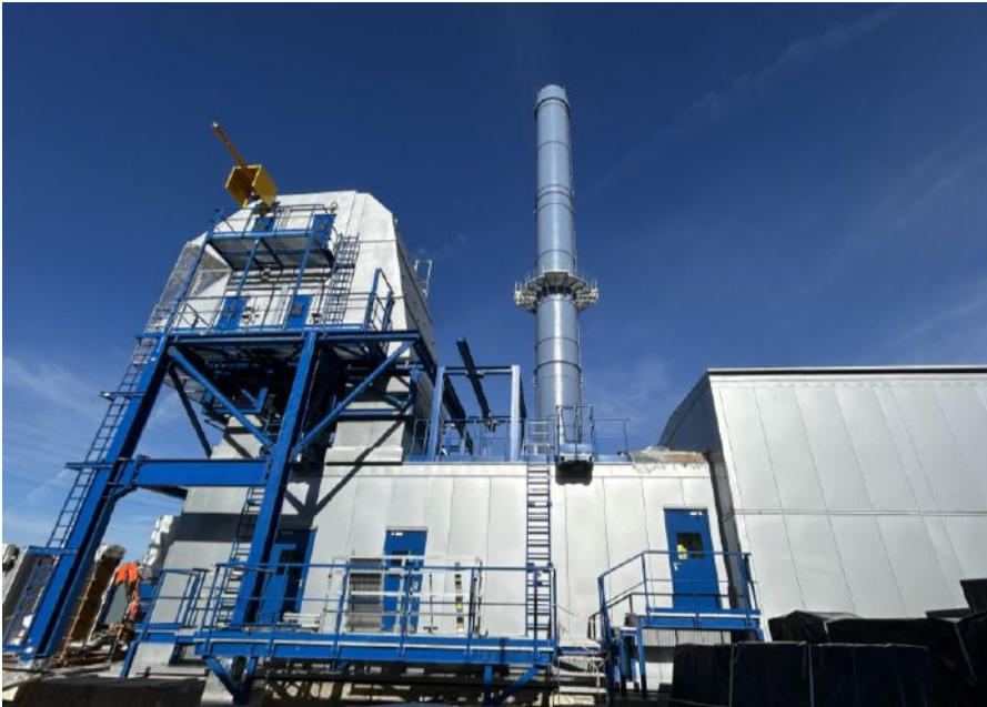
水素ガスタービン発電所
