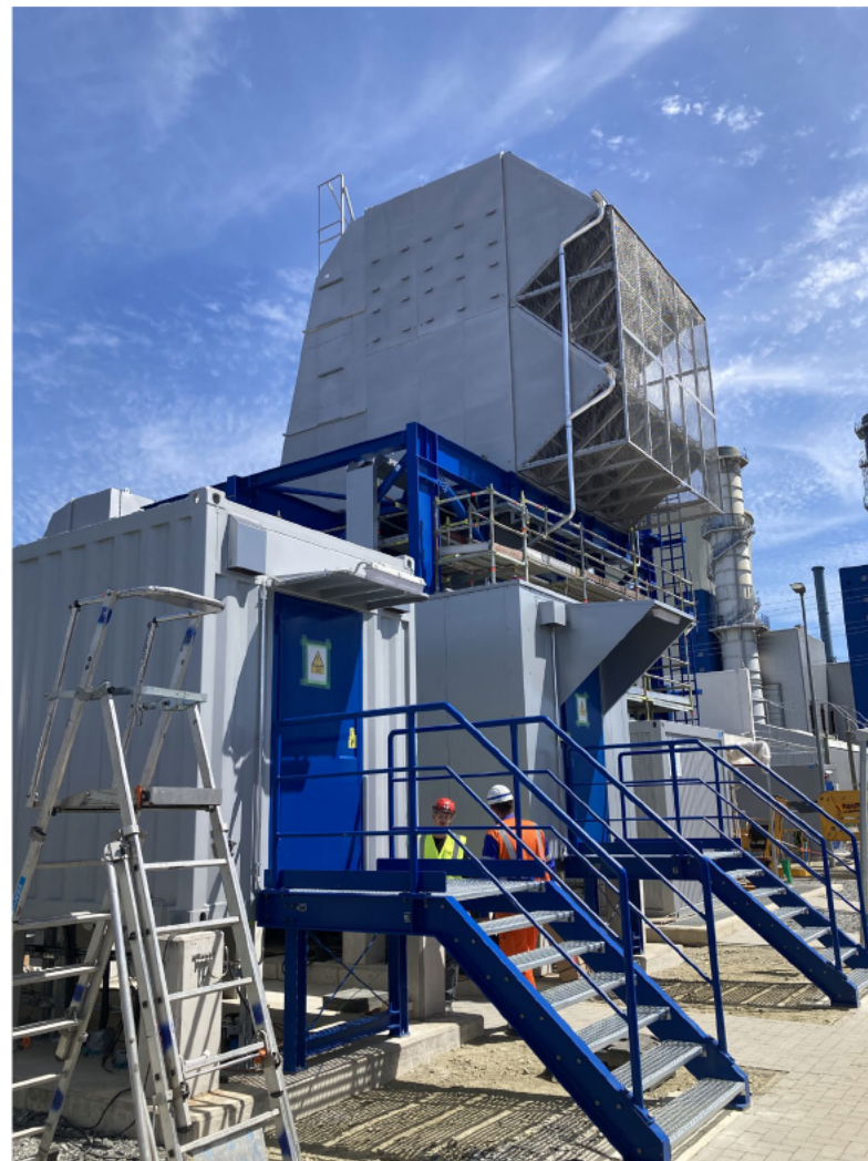
水素ガスタービン発電装置 本体
