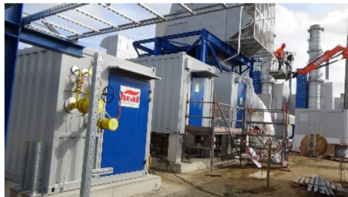
水素ガスタービン関連装置
