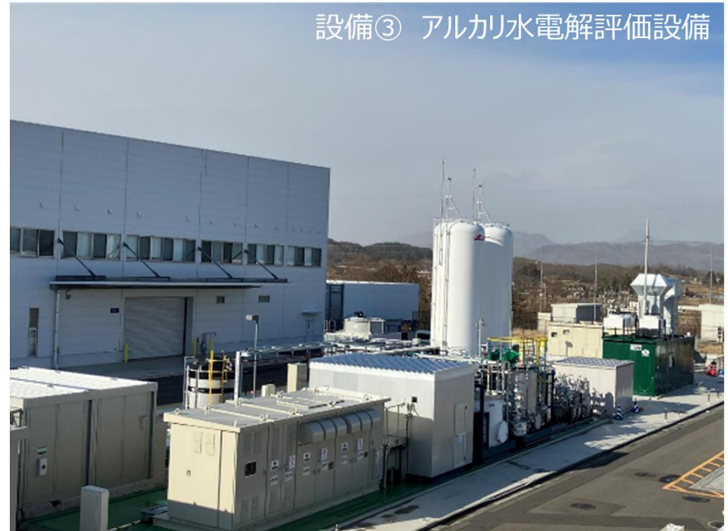
2024年度 アルカリ水電解装置設置完了
