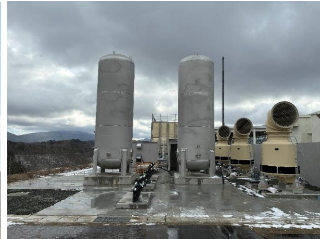
水素・酸素 低圧ガス 受入設備
