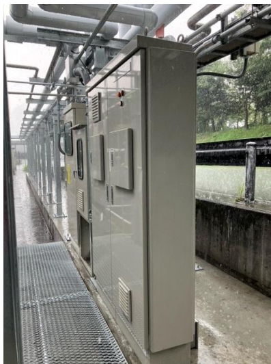
連携制御システム制御盤
