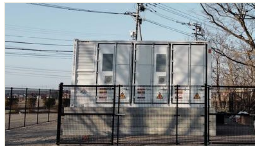
石川県 2MW / 4MWh
