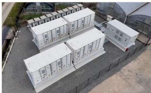
福岡県 2MW / 8MWh
