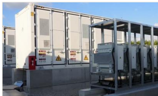
徳島県（国府） 2MW / 4MWh
