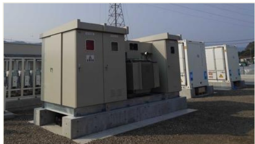
徳島県（吉野川） 2MW / 4MWh
